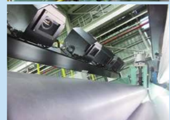
1600レベラーラインに自動キズ検査機を設置し、さらなるCS(顧客満足度)向上を図る
